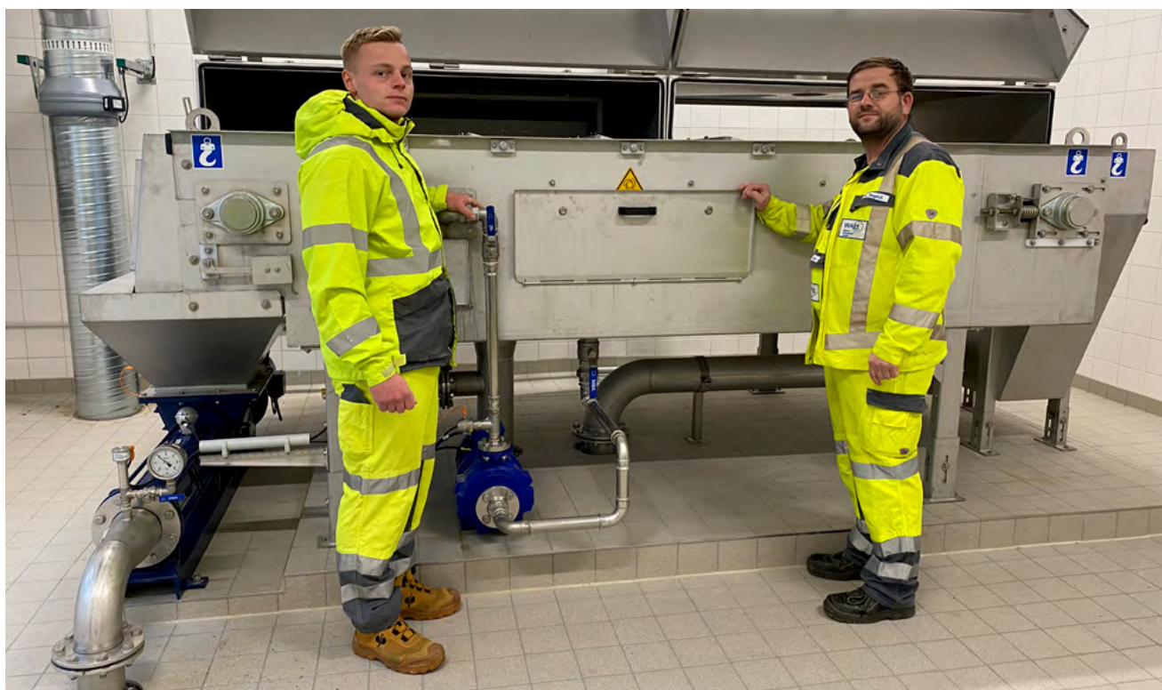
Die WAH-Mitarbeiter Tim Behrendt (li.) und Herr Andre Tangelst (r.) vor dem Bandeindickerin der neuen Kläranlage.
