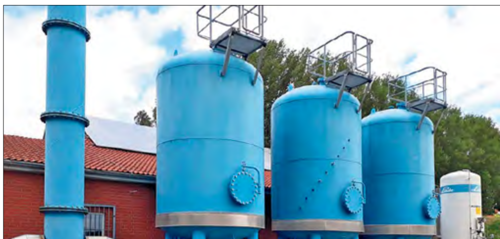
Im Wasserwerk wird die Kapazität der Wasseraufbereitung an den wachsenden Trinkwasserbedarf im WAH-Verbandsgebiet angepasst.
