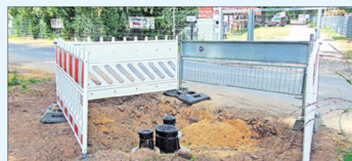
Diese Schiebergruppe ist inzwischen in Betrieb.
